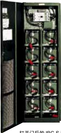
打开门后的 IBC-S 型电池柜
