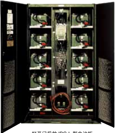
打开门后的 IBC-L 型电池柜
